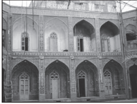
لوح (٢٤): واجهة المجنبه الشرقيه وتظهر عليها أعمال الصيانة والشرائط المظفورة - مدرسة اليزدي
